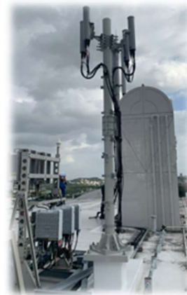
<本支持柱を使用した携帯電話 基地局のアンテナ>
