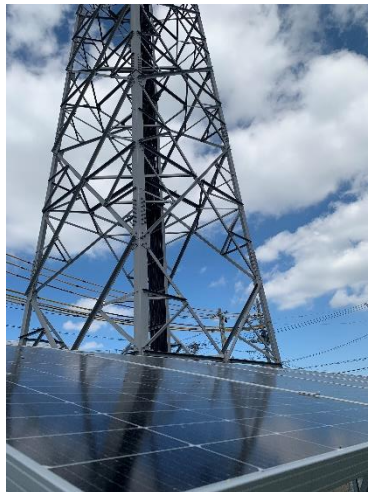
<サステナブル基地局>
